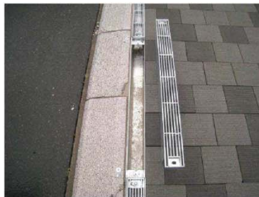
メンテナンス時にボルトを外し 蓋を取り出す
