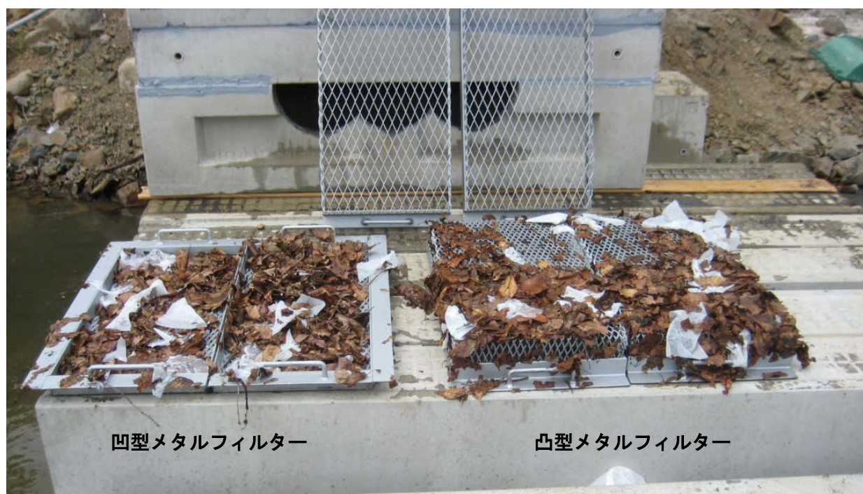
写真1 凹型メタルフィルターと凸型メタルフィルターのゴミ付着による閉塞状況
